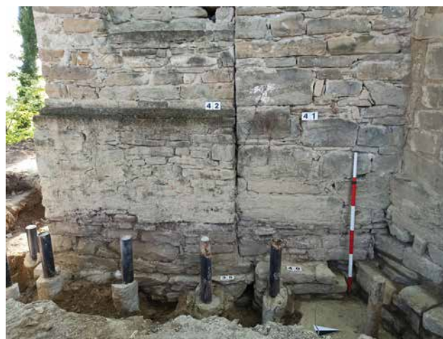
Fig. 105. Marsaglia. Cappella di S. Ponzio. Rapporti tra le murature del campanile (us 42) e la sua fondazione (us 35) con la facciata sud della cappella (us 41) e la sua fondazione (us 40) (foto F.T. Studio s.r.l.).
