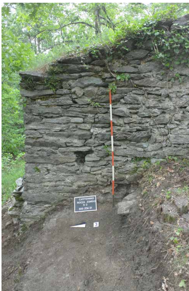
Fig. 81. Cartignano. Rocca dello Zoardo. Prospetto della parete ovest della torre (foto F.T. Studio s.r.l.).
